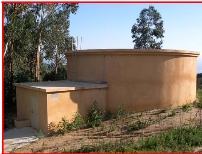
Le réservoir du Col du Pruno, sur la route du Château de la Punta, d'une capacité de 500 m3
